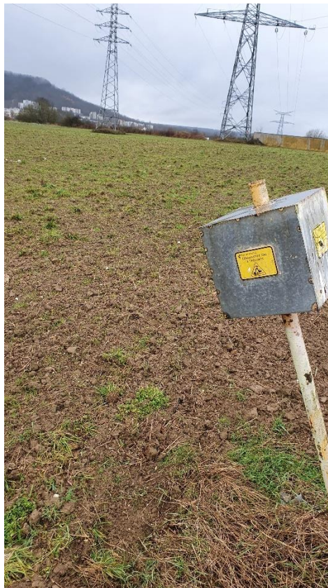
Figure 4: Photo de la localisation approximative de la canalisation de gaz au niveau de la zone 1
