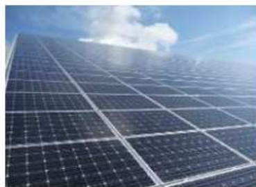
Exemple de panneaux solaires photovoltaïques
