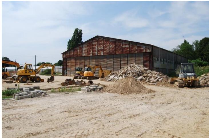
Figure 131 : Installations du Centre AFPA (Source : Egis, juillet 2021)
