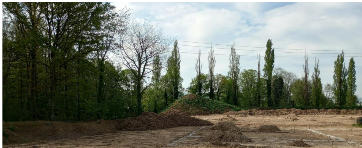
Vue 5 proche : Un espace dédié aux formations BTP, toujours dans l'emprise projet. Plusieurs boisements ceinturent le site, réduisant son impact visuel. (Source : Egis, mai 2023)
