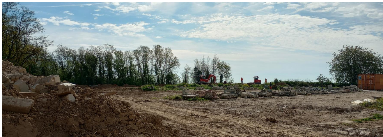
Vue 6 proche : Un espace dédié aux formations BTP, toujours dans l'emprise projet. Le nord du site d'étude est en point haut par rapport au sud du site. (Source : Egis, mai 2023)
