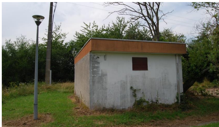
FIGURE 23 POSTE DE LIVRAISON PRIVE ET ET DE DISTRIBUTION HTA
