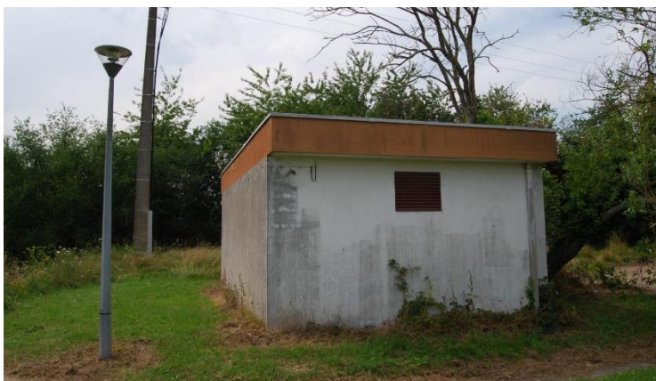
FIGURE 23 POSTE DE LIVRAISON PRIVE ET DE DISTRIBUTION HTA
