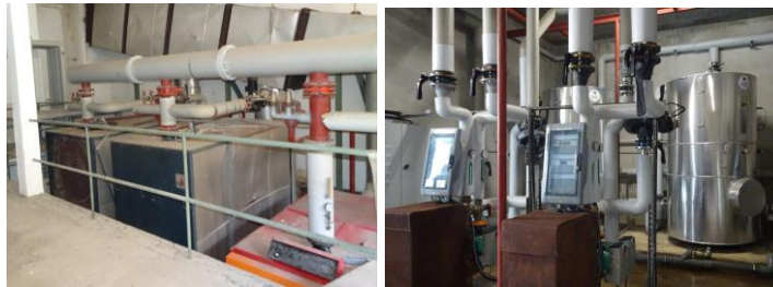
Photographie 8 : Chaufferie pour le chauffage (à gauche) et pour l'eau chaude sanitaire (à droite) (source : Egis)
