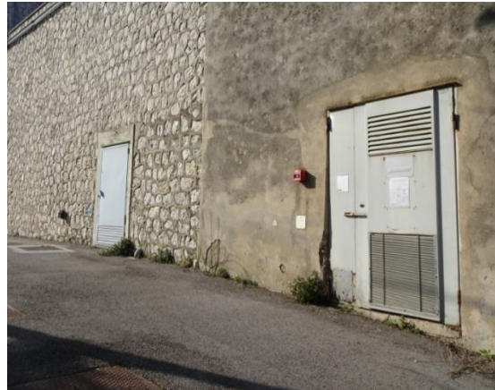
Photographie 7 : Poste de transformation électrique présent dans le mur d'enceinte (source : Egis)
